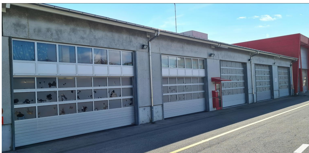
Figure 2- Façade OUEST - Dégâts grêle
